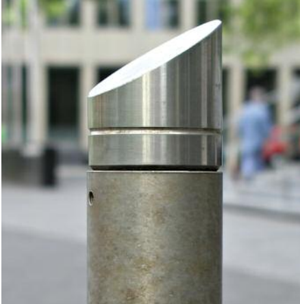
Dieser Poller aus nichtrostendem Stahl AISI 316 (EN 1.4401) ist streusalzhaltigem Spritzwasser von vorbeifahrenden Autos ausgesetzt. Der untere Teil ist grob, der obere fein geschliffen, was den Unterschied in der Korrosionsbeständigkeit erklärt. © IMO A
