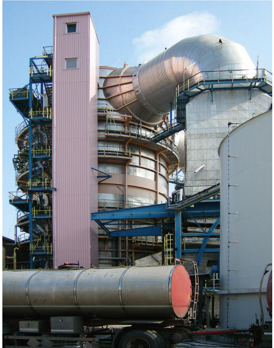
Austenitische nichtrostende Hochleistungsstähle in der Rauchgasreinigung © Outokumpu
